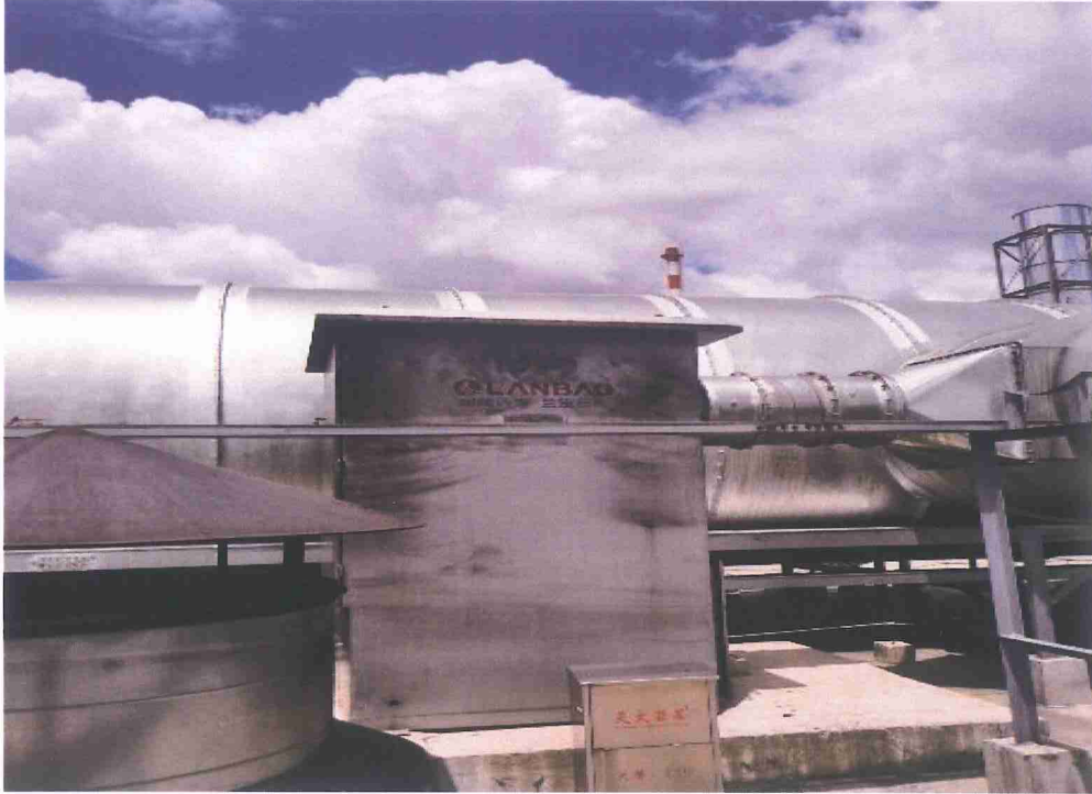
废气处理设备 (B区2#)
