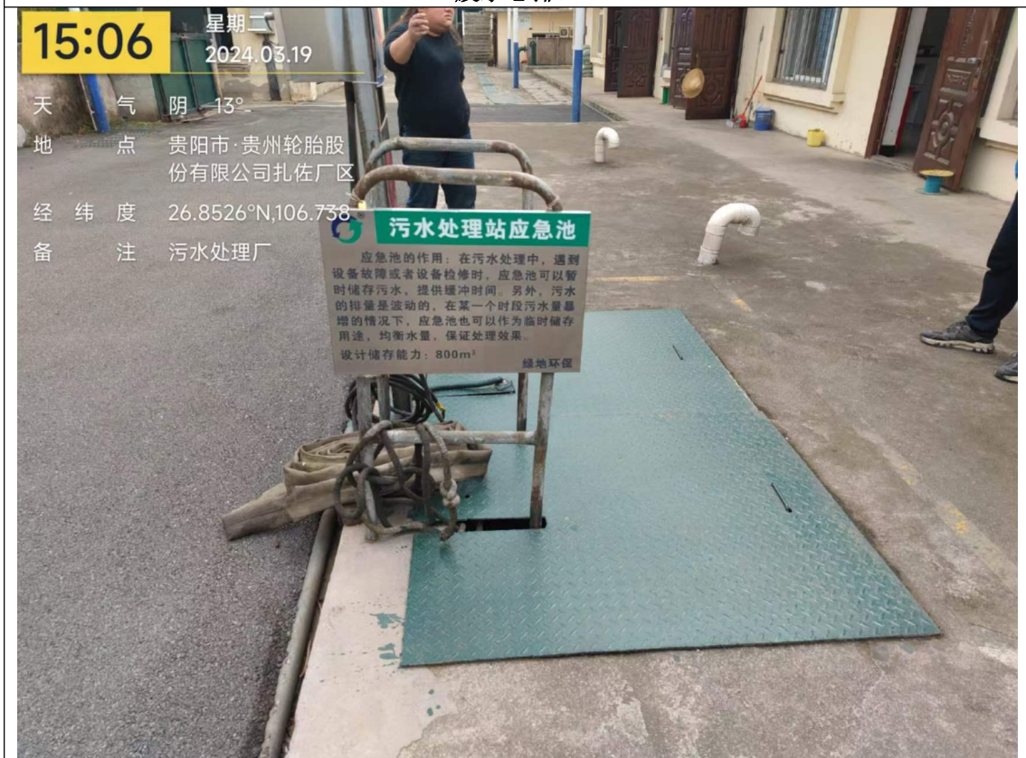
污水处理站应急池
